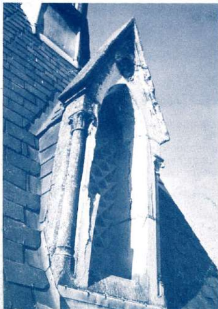
L'état des lucarnes était un danger permanent pour les usagers de l'église.
